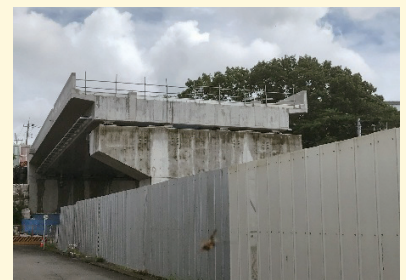
工事が中断された3・4・24号線 (2020年撮影)
